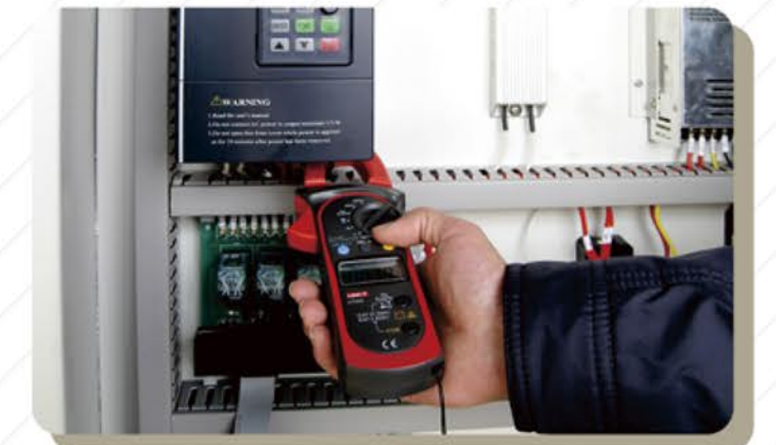
檢測控制櫃內電路
